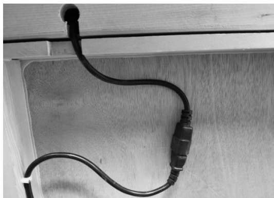
(1) priključite konektorje kablov grelnice, prepričajte se, da kabli niso ujeti med stropnim panelom in ostalimi paneli.
